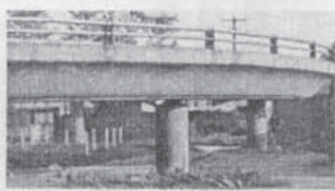
回澜立交固定墩开裂, 一般墩完好
