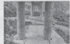
—新房子大桥右桥墩基岩移位
