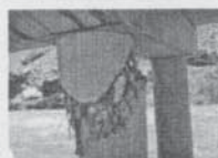
—墩柱剪切破坏
