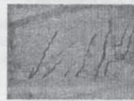
庙子坪大桥腹板出现大量斜向裂缝
