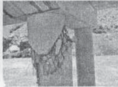
震后墩身发生剪切破坏
