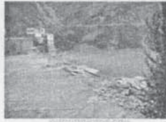
南坝大桥全桥垮塌
