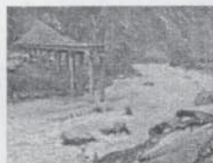
彻底关大桥映秀岸被巨石砸垮3孔
