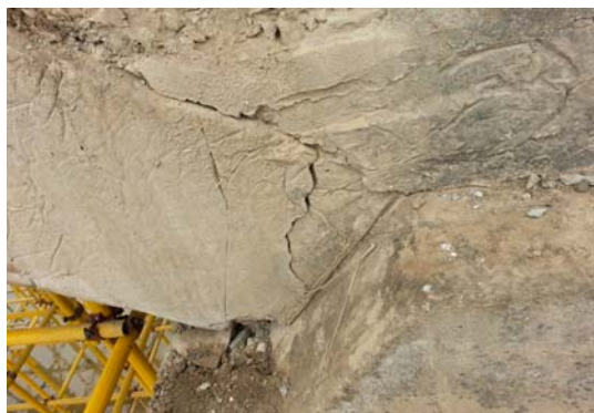
图二 拱脚与墩台结合处有轻微位移
