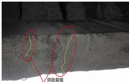
图三 拱肋裂缝
