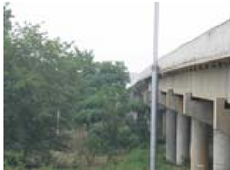
天门河大桥径流收集装置 3
