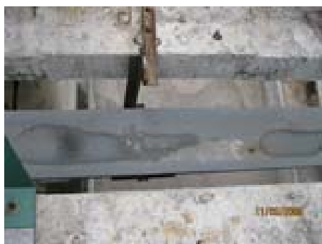
岳口汉江二桥径流收集装置 2
