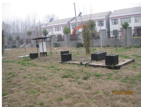
珠玑收费站污水处理装置(处理量 5T/h)
