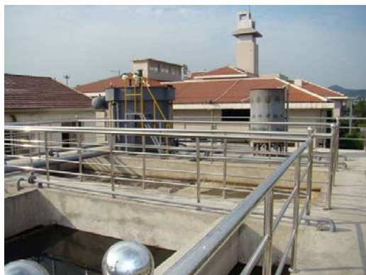
图 51 大悟服务区污水处理设备
